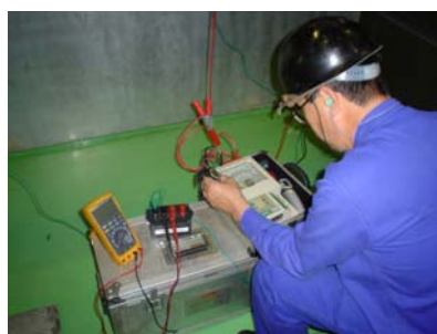
Figura 7. Diagnose do Gerador em 2003.
