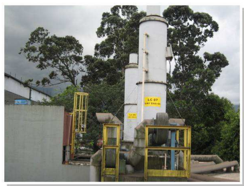
Figura 4. Sistema de lavagem de gases
