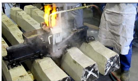
Desprendimento de gases no pré-aquecimento 07m:26s
