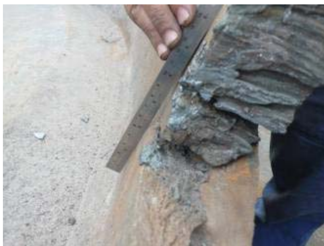
Figura 10. Deformação do cone inferior, lado interno.
