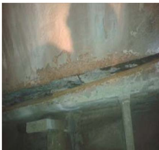
Figura 2. Abertura da trinca.
