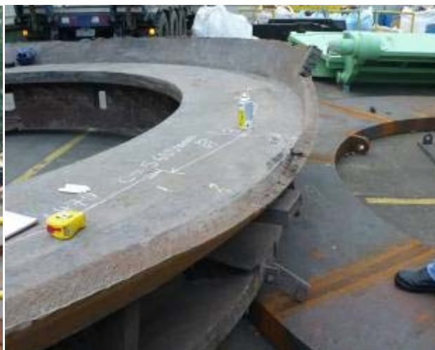
Figura 5. Vista de parte da trinca.
