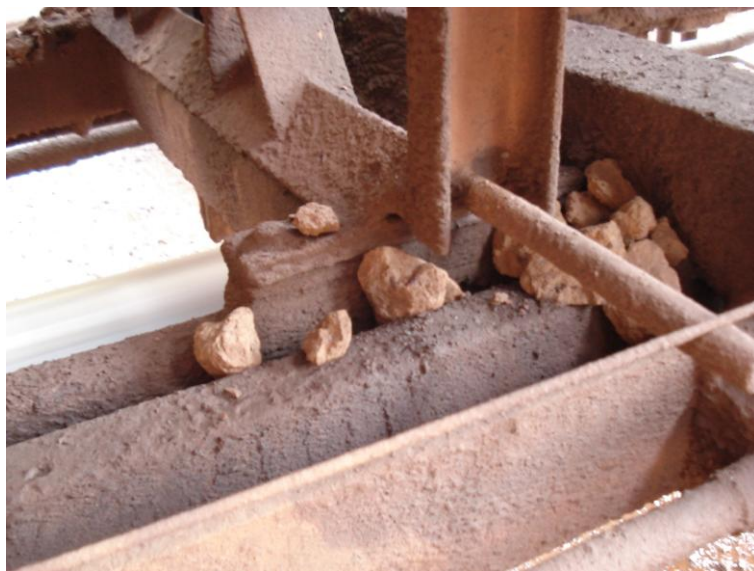
Figura 13 – Acumulo de material em pontes de pesagem
