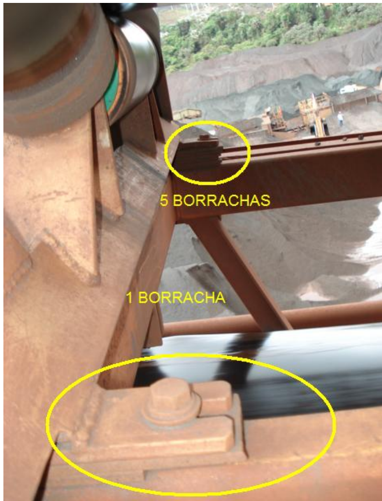
Figura 9 – Desalinhamento de roletes na área de pesagem
