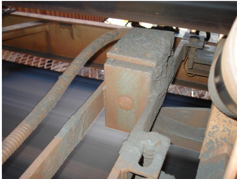
Figura 12 – Sujeira em pontes de pesagem
