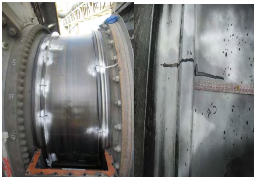
Figura 10. (a) – Visão Geral da trinca; (b) – Detalhe da trinca mais crítica.
