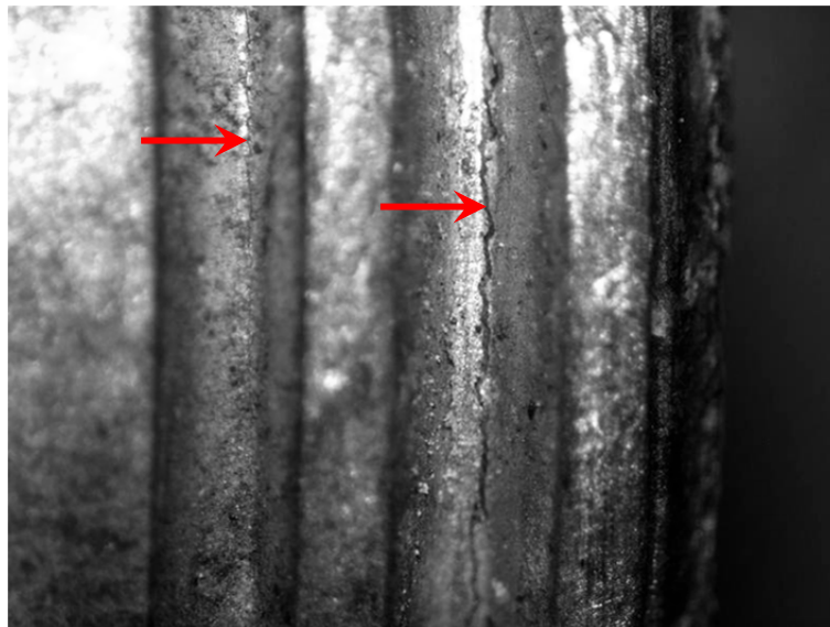
Figura 6: Imagem em lupa de baixo aumento da lateral do componente. As setas indicam as trincas.
