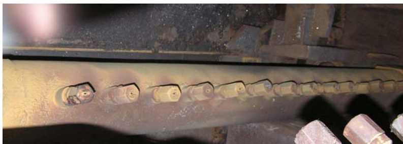
Figura 2. Chuveiro com bicos desalinhados
