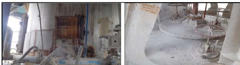
Figura 4. Desgastes de estruturas e estofamento do piso do canal
