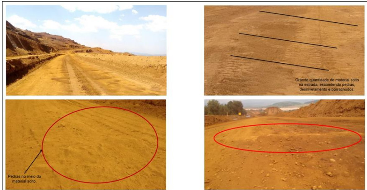
Figura 4. Estradas da mina antes das melhorias de infraestrutura.
