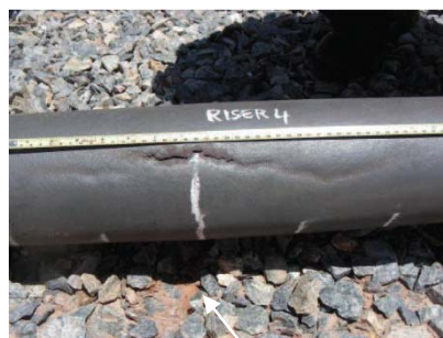
Figura 1 Riser que falhou em operação. A seta indica o sulco formado pela trinca interna, bem como a própria trinca que atingiu a parede externa.
