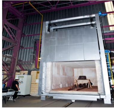
Figura 6. Vista geral do Forno de Tratamentos Térmicos, utilizado para os tratamentos da Barra Teste e de componentes diversos, na unidade da PTBRA, localizada em Santa Cruz – RJ.
