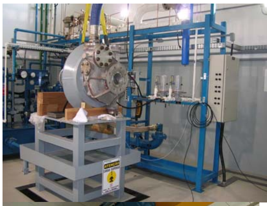
Fonte: Centro de Confiabilidade da White Martins Figura 7 Vista Interna da Instalação
