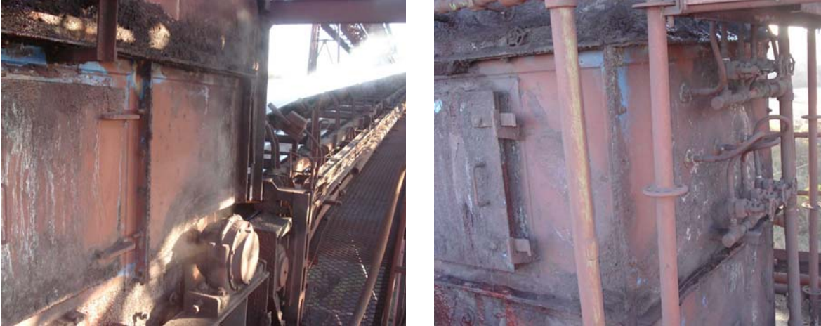
Figura 1. (a) Entrada do chute de transferência; (b) sistema de aspersão de água.
