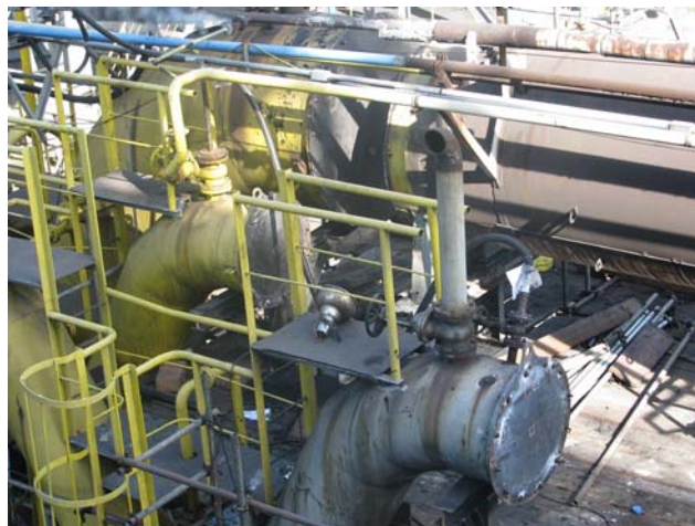
Figura 3. Isolamento das tubulações de gás da Coqueria 1.
