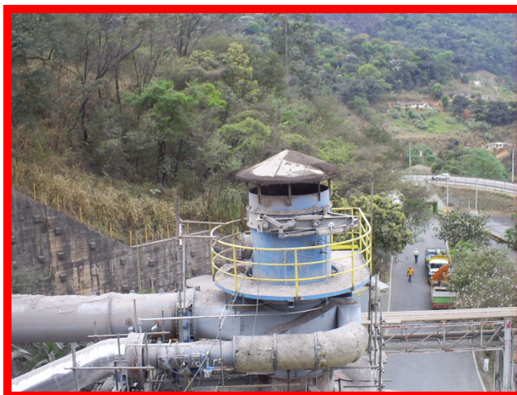
Figura 3: Com dispositivo de desempoeiramento em operação
