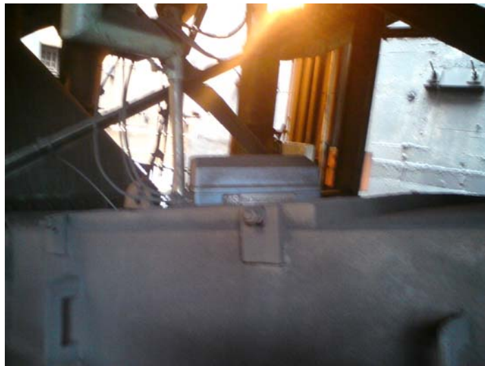
Figura 6. Equipamento já instalado na área do silo de carvão vegetal.
