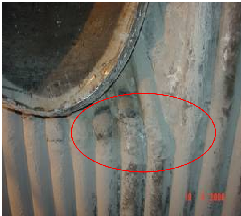
Figura 7. Desgaste nos tubos da chaminé.
