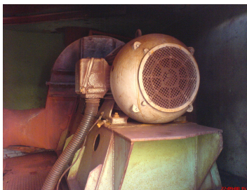
Figura 1. Motor do exaustor de Gases do Forno monitorado.
