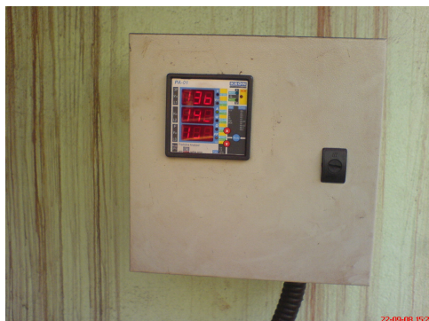
Figura 3. Painel de comando do motor onde o PA foi instalado.
