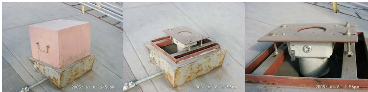
Figura 6. Fotos das montagens dos sensores no teto do gasômetro.
