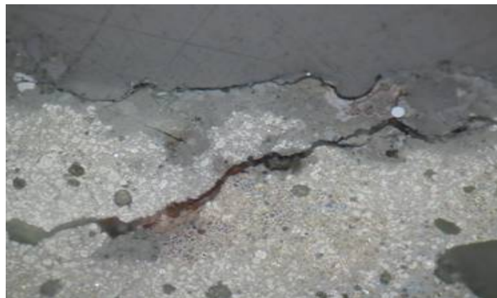
Figura 7. Formação de trincas no limite da face quente
