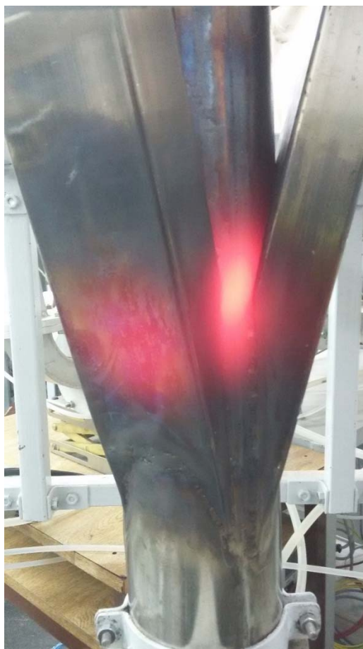
Figura 5. Perda de energia térmica pela superfície externa do forno.
