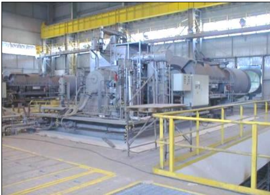
Figura 2 – Vista Tubos Sopradores 85 e 86.
