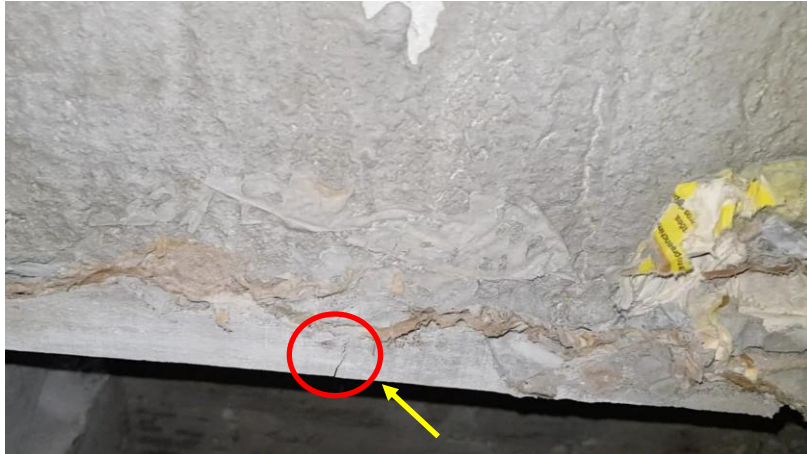
Figura 8. Pequena fissura apresentada na viga reforçada com vergalhões de aço, após um carregamento de 9.000 kgf.
