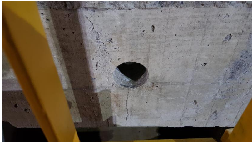
Figura 8. Fissura apresentada após submeter uma das vigas perfuradas (50 mm de diâmetro de furo), sem reforço estrutural, a um carregamento de flexão a três pontos de 6.000 kgf.
