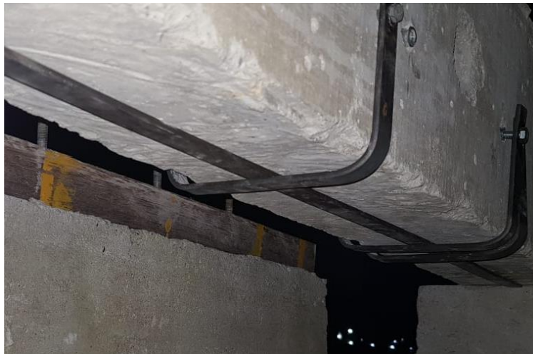
Figura 7. Resultado final do reforço estrutural da viga através de uma barra de aço.
