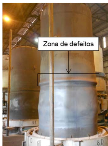
Figura 3: Abafadores de recozimento em caixa com a formação da pança que leva a deterioração.
