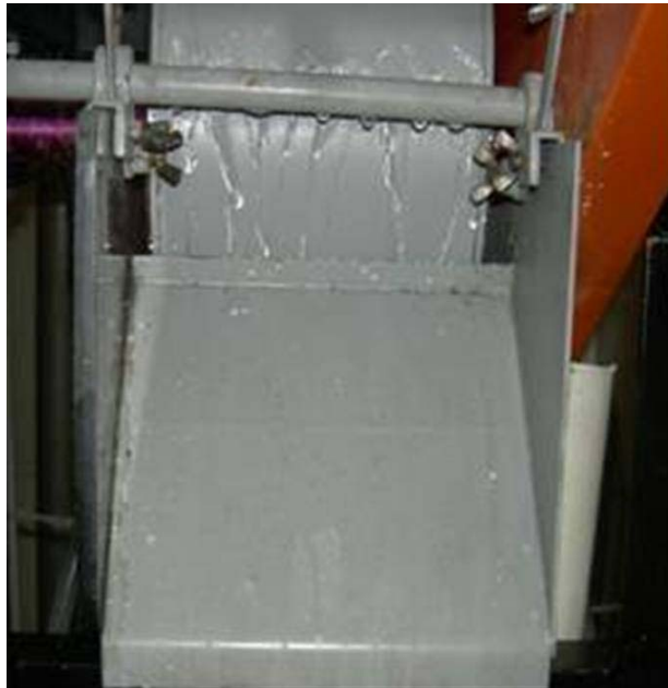
Figura 5 : Separador magnético a úmido iniciando a operação.
