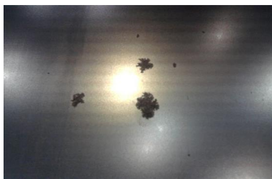
Figura 1 – Oxidação em material sem proteção superficial.
