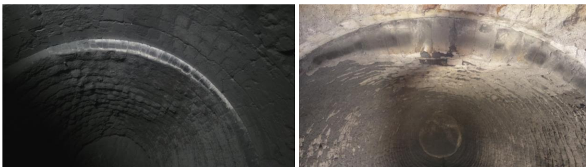
Figura 2. Fotografia de um carro torpedo evidenciando a severa oxidação do teto.
