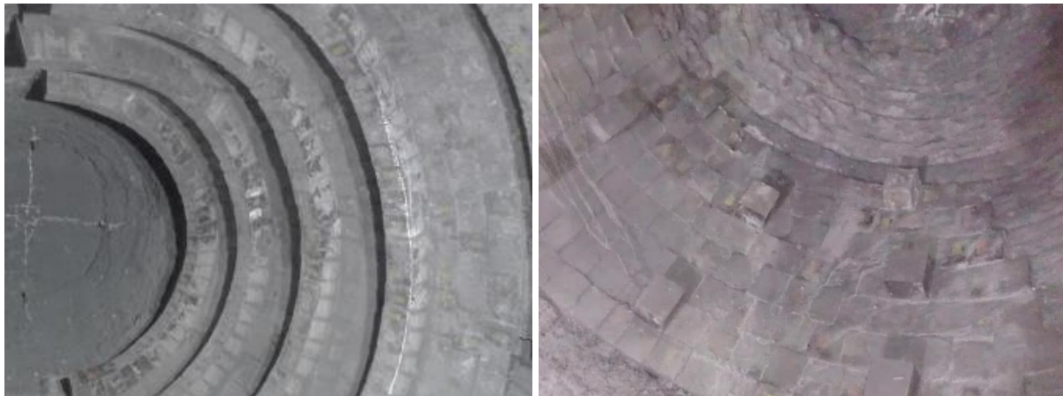
Figura 11. Fotografias das ancoragens de tijolos refratários em carro torpedo.
