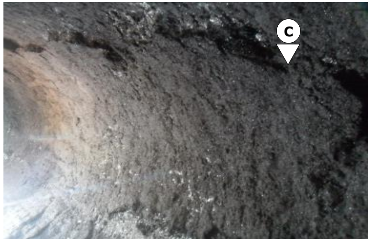
Figura 10. Fotografia evidenciando a camada de shotcrete após o transporte de 100.000 t de gusa: C - camada remanescente de concreto.
