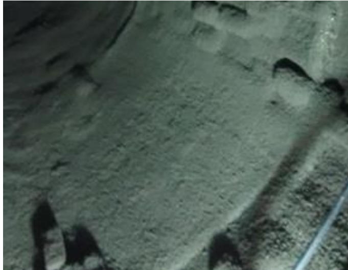
Figura 6. Fotografia da aplicação de uma camada fina e irregular de proteção na superfície do tijolo.
