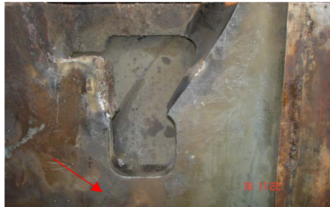
Figura 5. Trinca iniciada no canto oposto da abertura, no fundo da placa.
