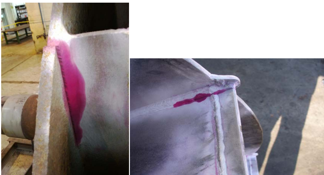
Figura 1. Fissuras na região da solda entre a pá e o disco lateral do rotor.
