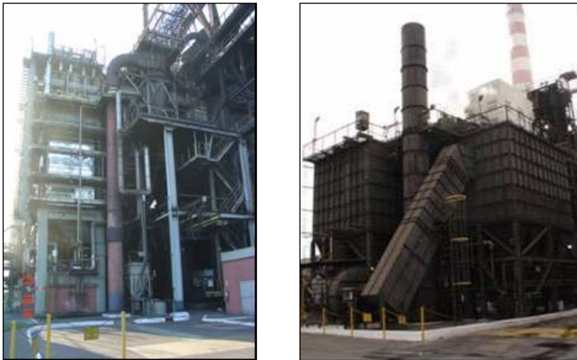
Figura 7. Sistema de despoeiramento da carga e descarga do CDQ
