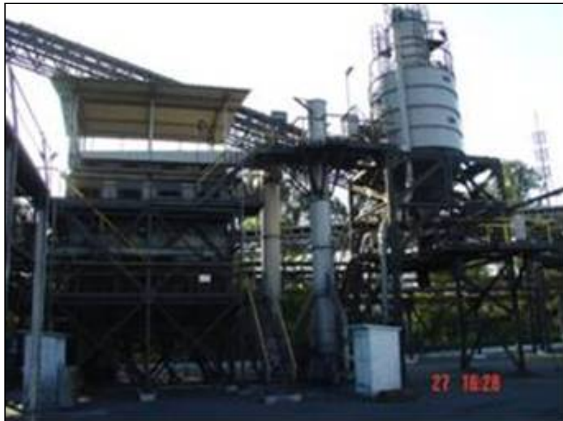
Figura 4. Sistema de despoejamento da área de tratamento de coque
