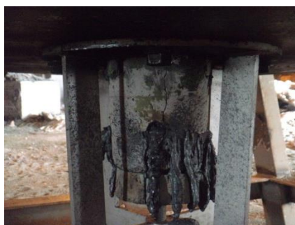
Figura 5. Trinca no material refratário
