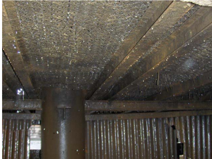
Figura 15– Recheio da torre após otimização da cloração
