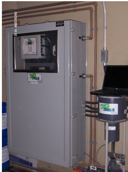
Figura 7: Equipamento de automação Trasar 3D
