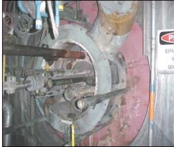
Figura 6- Câmara de gás Coqueria do queimador
