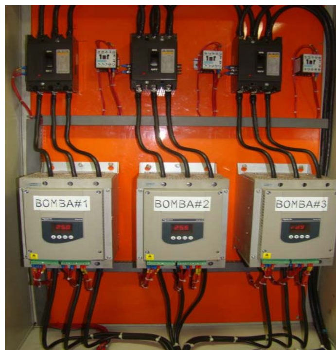
Figura 9 - Soft-Starters dos motores.
