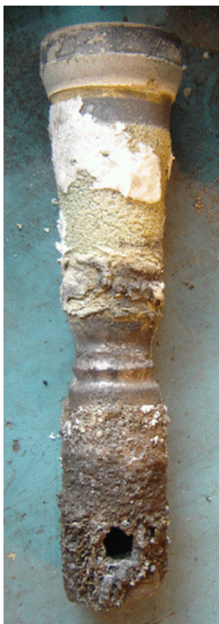
Figura 1: Válvula submersa desgastada.
