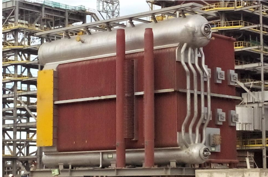
Figura-3 Caldeira auxiliar
