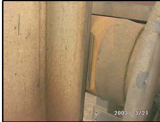
Figura 5 – Desgaste dos rolos externos.
