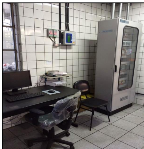
Figura 5 - Sala de controle
