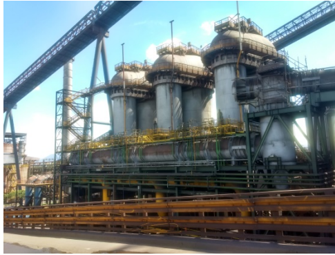
Figura 3. Conjunto dos Regeneradores na Ternium BR
