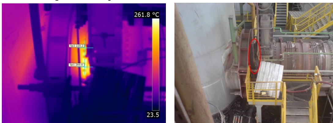
Figura 6. Termograma e foto da válvula de ar quente
