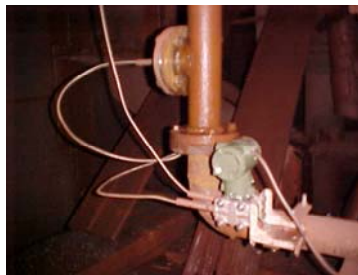
Figura 6. Medidor de pressão diferencial instalado.
