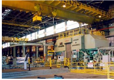
Figura 3. Laminador de encruamento n.º2.
