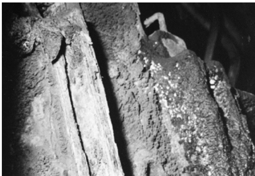
Figura 3. Exemplo genérico de severa corrosão por oxigênio em vigas estruturais na câmara de vapor; o aço-carbono é transformado em camadas de produtos de corrosão de óxido de ferro – 8 anos de operação.
