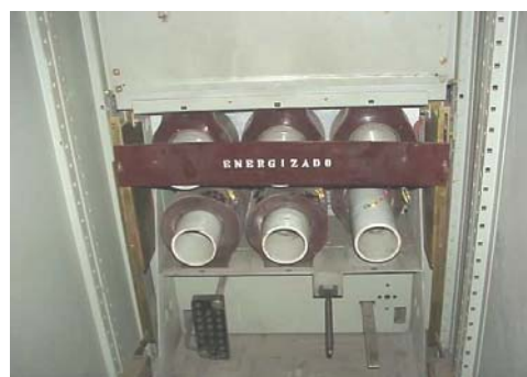
Figura 7: TC'S no interior de painel elétrico.
