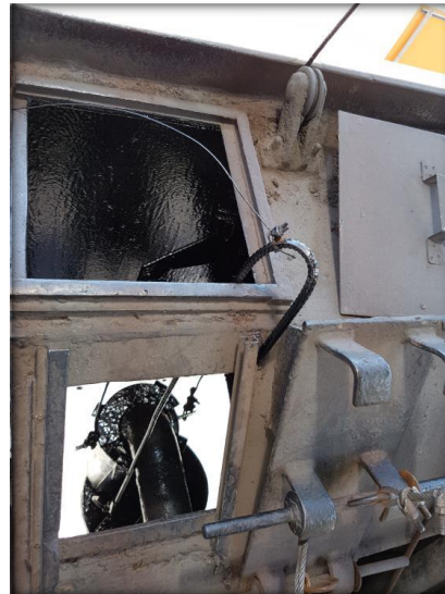
Figura 5 – Abertura para monitoramento visual do nível
