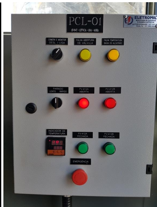
Figura 11 – Painel de comando remoto das válvulas
