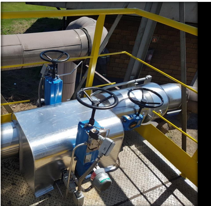
Figura 10 – Válvulas pneumáticas para o carregamento do alcatrão
