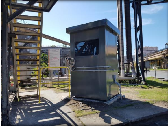
Figura 6 – Nova cabine de carregamento de alcatrão
