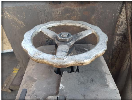
Figura 4 – Válvula de carregamento de alcatrão
