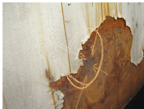
SINAL DE QUEIMA POR ARCO NA TAMPA DE VEDAÇÃO (LADO DE 13.8kV)
