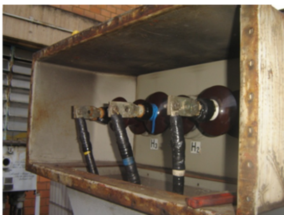
TERMINAÇÃO DE ALTA TENSÃO DO TRANSFORMADOR DE 3.75MVA
