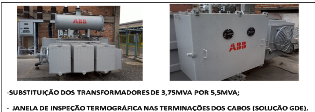
Figura 10. Transformadores de 5,5MVA.
