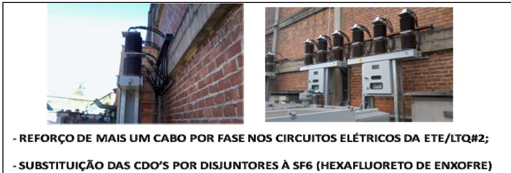
Figura 9. Novos disjuntores à SF6 e reforço dos cabos.
