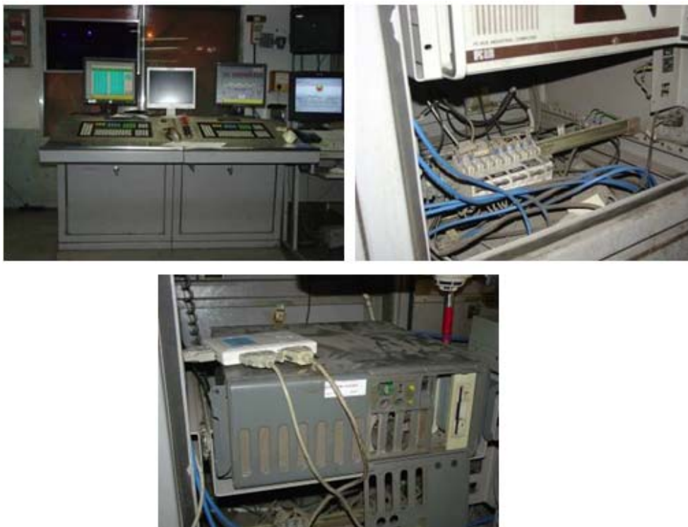
Figura 4: Sistema de automação do VOD1 – equipamentos (instalação anterior).
