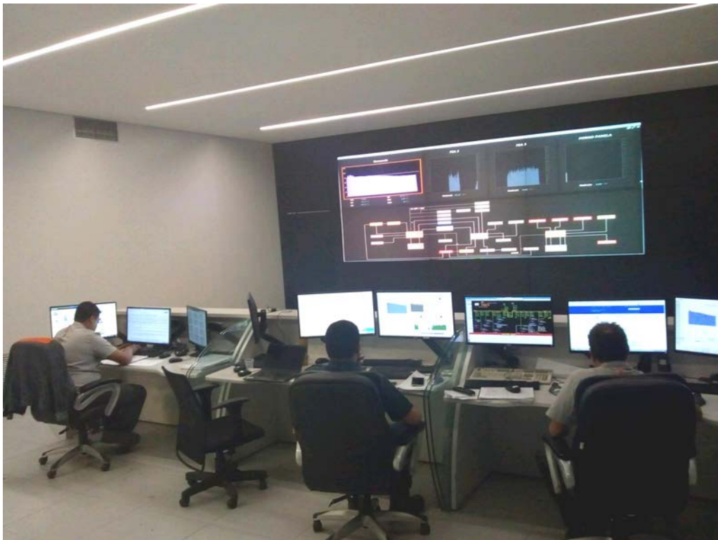
Figura 6. Centro de Comando Integrado
