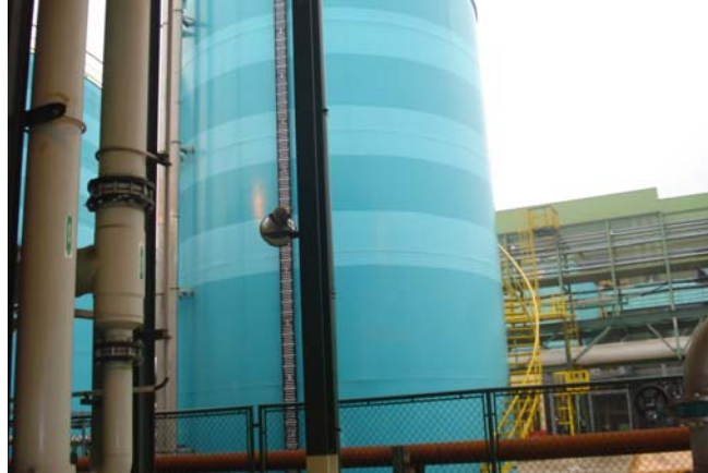
Figura 1: Tanque de água desmineralizada.
