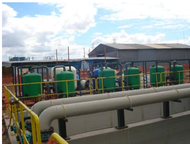
Figura 7: Skids adotado para o tratamento da limpeza química na TKCSA.
