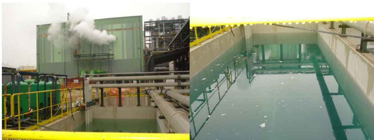
Figura 9: Tanque de Neutralização da Planta de Água Desmineralizada
