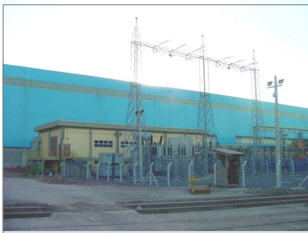
Foto 1 – S/E's LTQ 1 e 2
